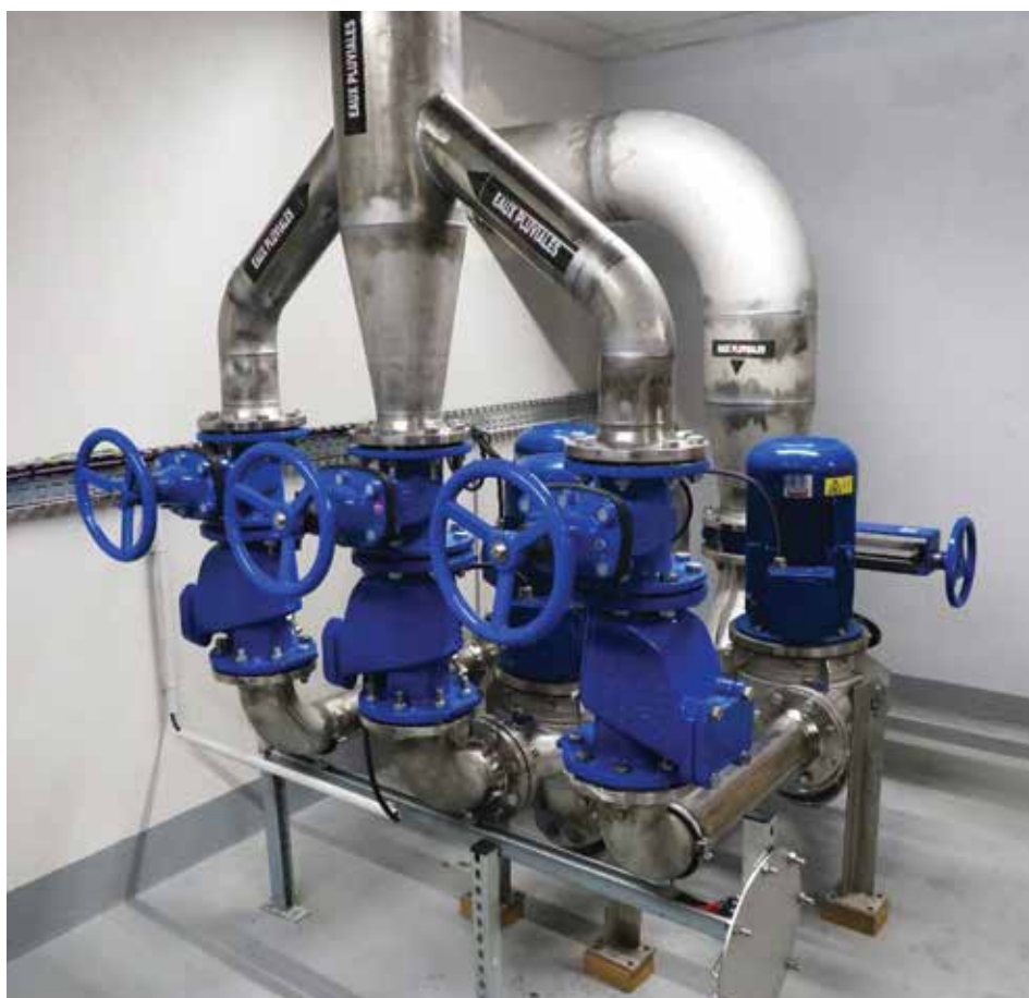
Vue d'ensemble de la station de pompage fournie par Side Industrie
